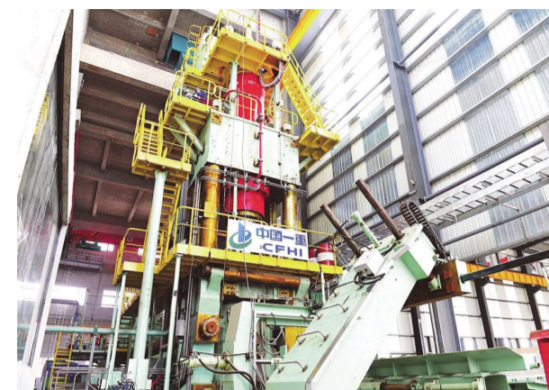
7月30日,山西梅山湖科技有限公司新建年产六万吨超功率石墨电极建设项目正在进行设备安装调试。该公司充分利用稷山经济技术开发区西社园区以针状焦、改质沥青和焦炉煤气为原料的优势,制成超功率石墨电极,为开发区碳基新材料产业发展注入新活力。 ■栗宇建 摄
