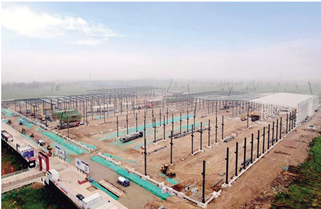
科学导报 7 月 16 日，在山西转型综改示范区潇河新兴产业园区太重中大型工程起重机智能制造项目建设现场，钢柱林立，工程设备轰鸣运转，随着大型吊车将钢柱吊运到指定位置，工人们有条不紊地将其固定。截至目前，该项目承台已基本安装完成，钢结构立柱完成超过 300 个。
