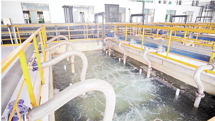
介休市昌盛煤气化有限公司水处理零排放综合利用系统中水车间。
