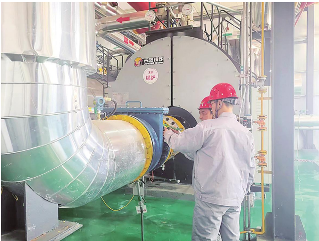
工作人员对低浓度瓦斯多孔介质燃烧制热设备进行维护。
